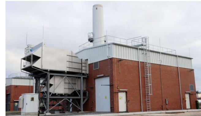
Gasverdichterstation Achim https://www.kreiszeitung.de (02.02.2024)
