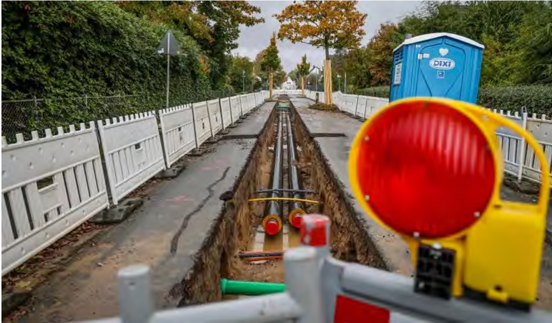
Abbildung 7: Fernwärmeleitung in der Clüverstraße; Quelle: Weser-Kurier / Strangemann 1
